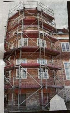
Die beiden Türme von Schloss Dorst sind im Zuge der Sanierungsarbeiten eingerüstet.
